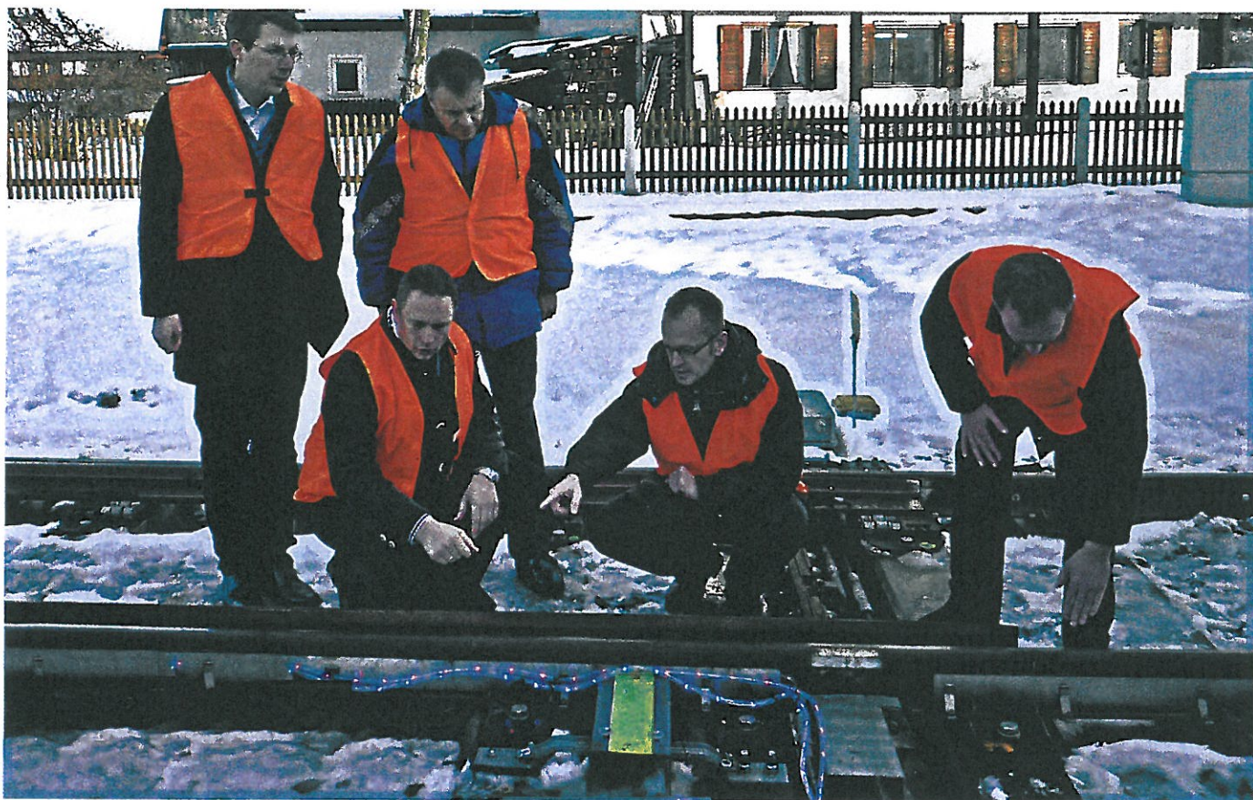
Einweihung der Weichenheizung im Bahnhof Farchant
