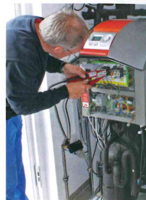
Blick in die Heizzentrale der Familie Funke. Kälteanlagenbaumeister Josef Keller nimmt letzte Feinjustierungen an der Wärmepumpe vor
